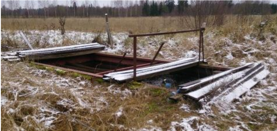
Foto 46. Kadjaste küla reoveepuhasti aeratsioonimahuti
