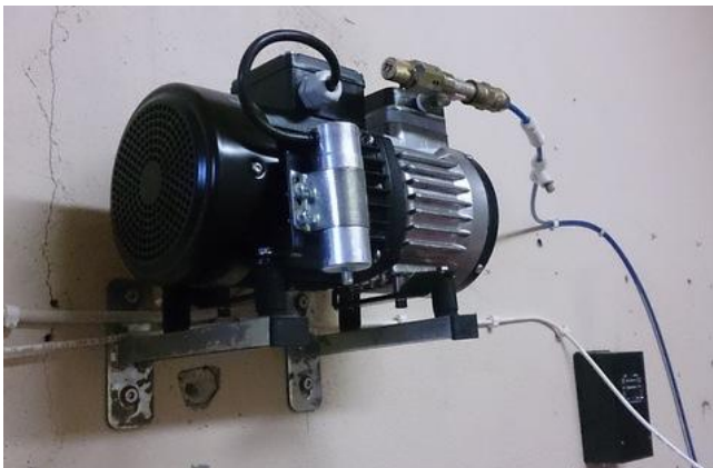
Foto 47. Kadjaste reoveepuhasti kompressor
