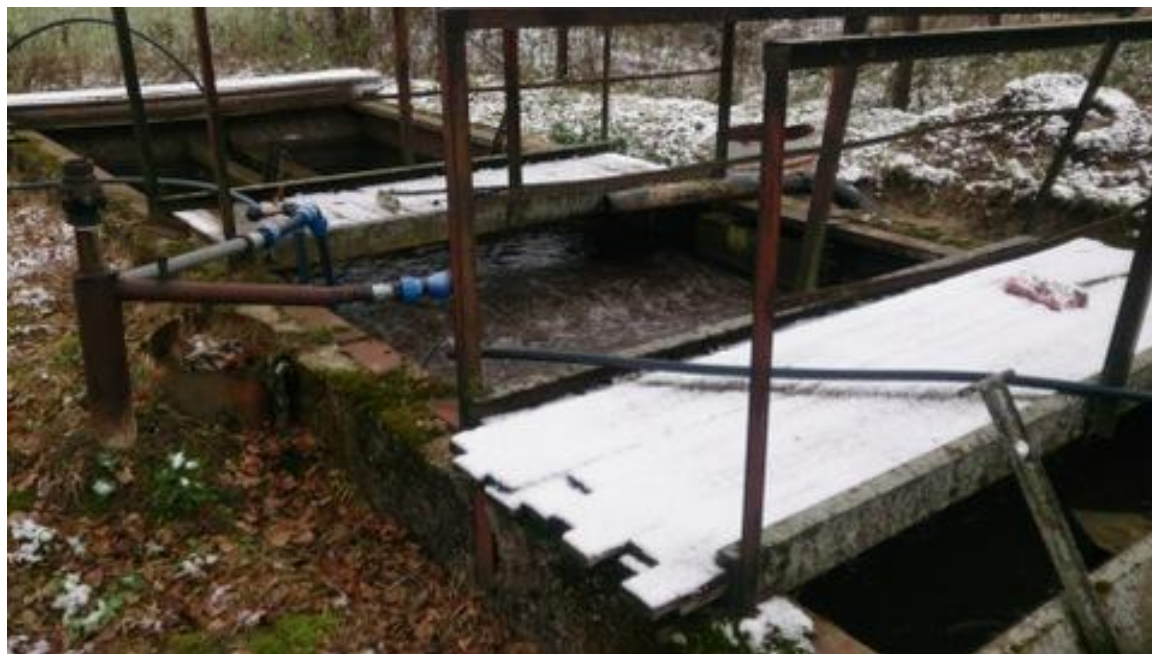
Foto 42. Suurejõe reoveepuhasti aeratsioonimahuti
