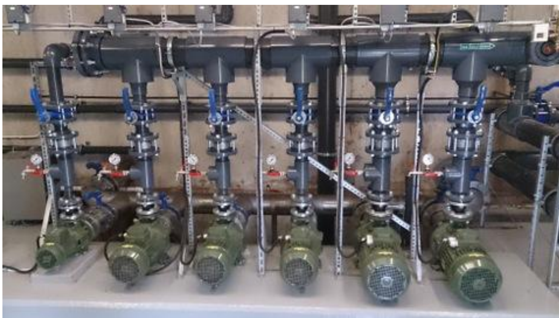
Foto 13. Pärnu-Jaagupi veetöötlusjaama sisevaade
