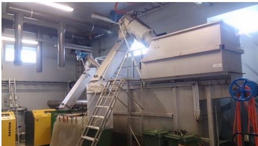
Foto 17. Pärnu-Jaagupi reoveepuhastihoone sisevaade I
