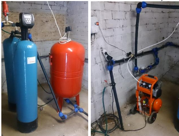
Foto 61. Võidula puurkaev-pumpla veetötlusseade, hüdrofoor ning kompressor
