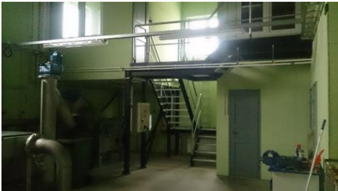
Foto 7. Vädra reoveepuhasti sisevaade
