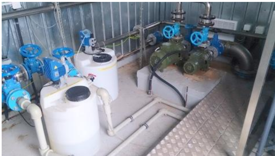
Foto 25. Vahenurme veetöotlusjaama desinfitseerimiseseadmed
