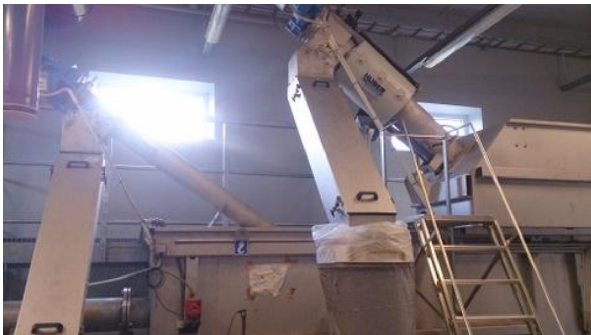
Foto 18. Pärnu-Jaagupi reoveepuhastihoone sisevaade II
