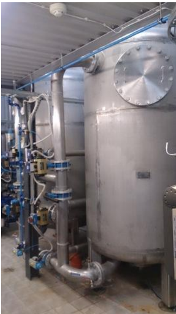
Foto 1. Veetöötlusjaama sisevaade I
