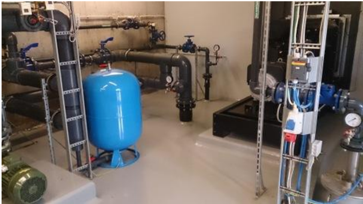
Foto 14. Pärnu-Jaagupi veetöötlusjaama sisevaade
