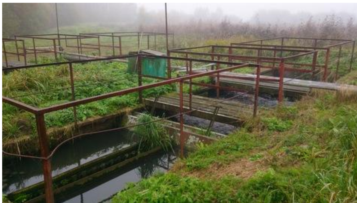
Foto 23. Libatse reoveepuhasti aeratsioonimahutid
