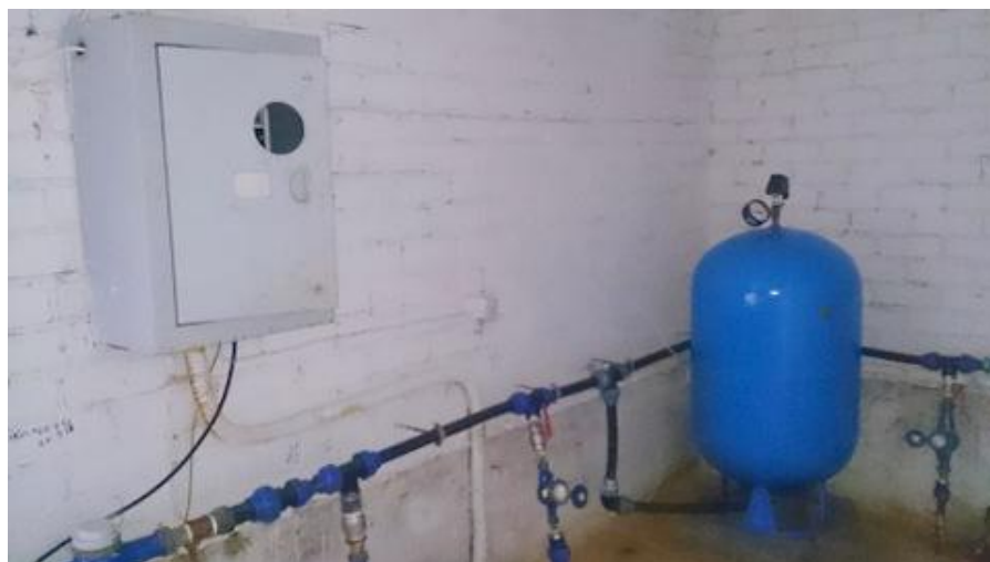
Foto 48. Kergu keskuse puurkaev-pumpla sisevaade
