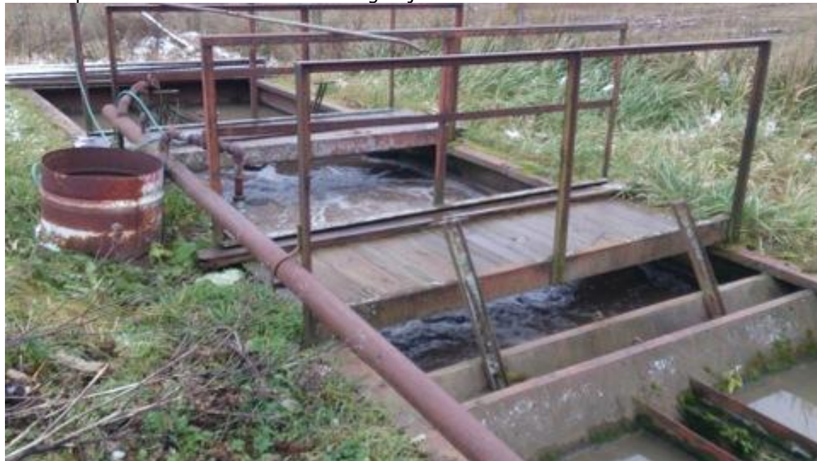
Foto 39. Pärnjõe küla reoveepuhasti aeratsioonimahuti
