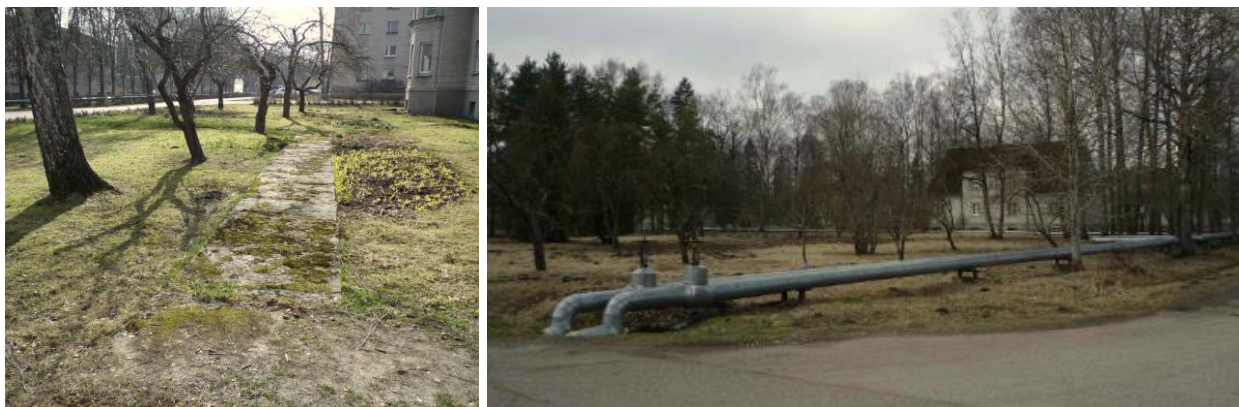
Joonis 2.10 Maa-alustes betoonkanalites ja maa-pealsed Tootsi kaugküttevõrgu torustikud
