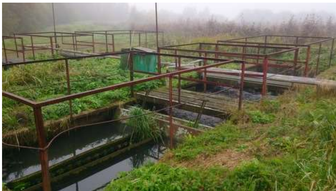
Foto 23. Libatse reoveepuhasti aeratsioonimahutid
