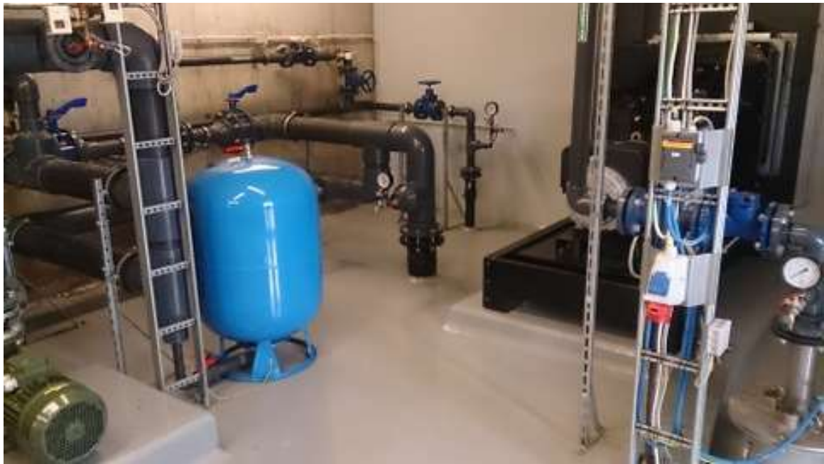
Foto 14. Pärnu-Jaagupi veetöötlusjaama sisevaade
