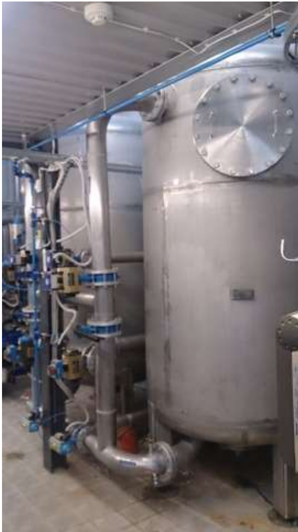
Foto 1. Veetöötlusjaama sisevaade I
