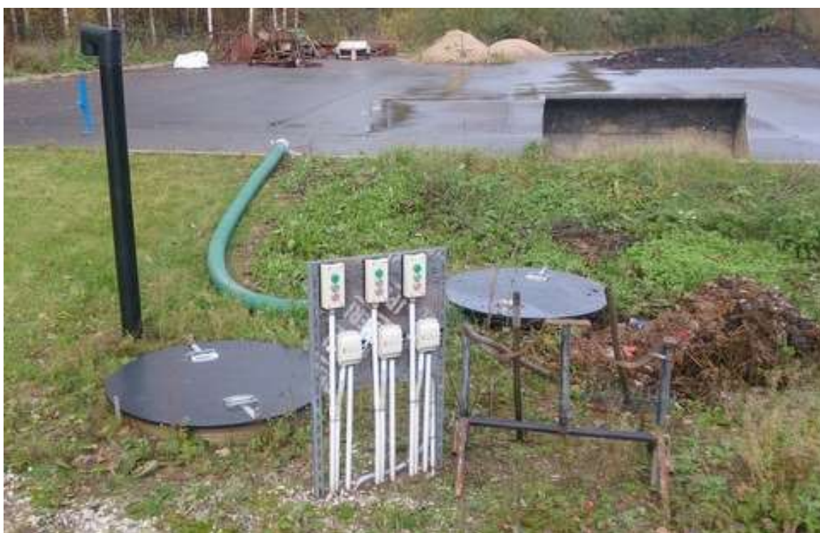
Foto 20. Purgimissõlm Pärnu-Jaagupi reoveepuhasti juures
