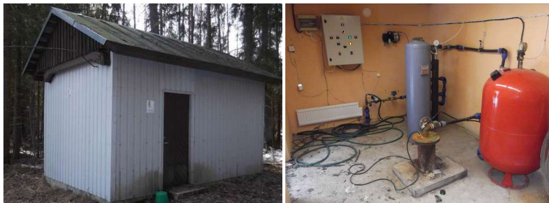
Fotod 37 ja 38. Pärnjõe Metsa puurkaev-pumpla (katastri nr 6363) ja veetöötlusjaam
