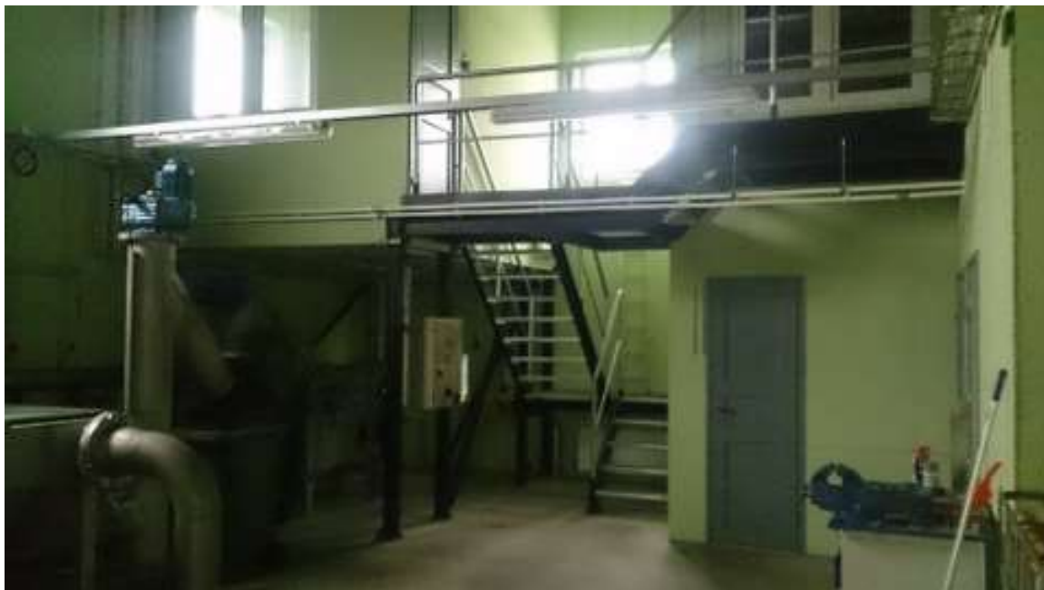
Foto 7. Vädra reoveepuhasti sisevaade
