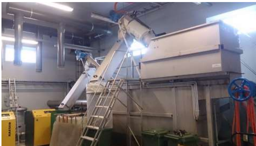
Foto 17. Pärnu-Jaagupi reoveepuhastihoone sisevaade I
