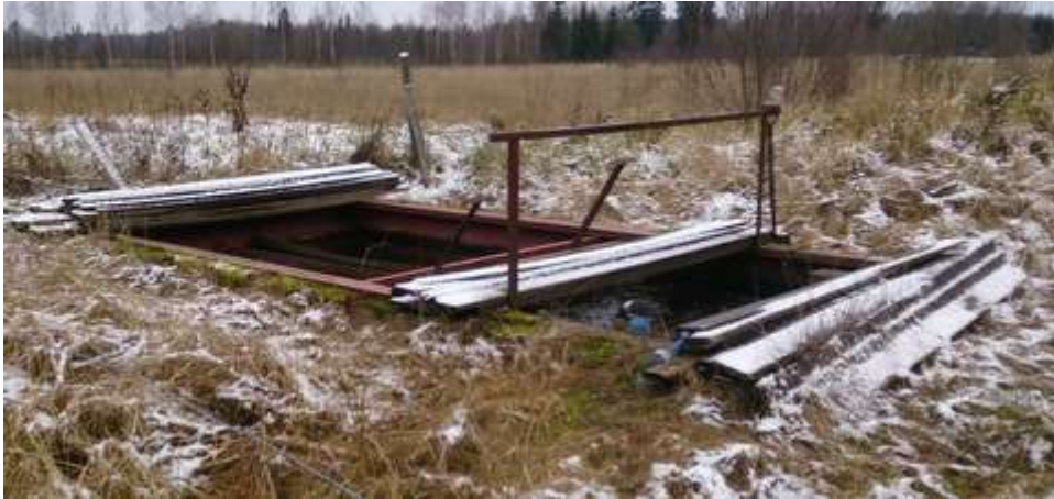
Foto 46. Kadjaste küla reoveepuhasti aeratsioonimahuti
