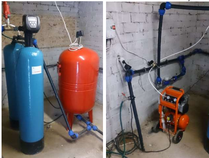
Foto 61. Võidula puurkaev-pumpla veetötlusseade, hüdrofoor ning kompressor
