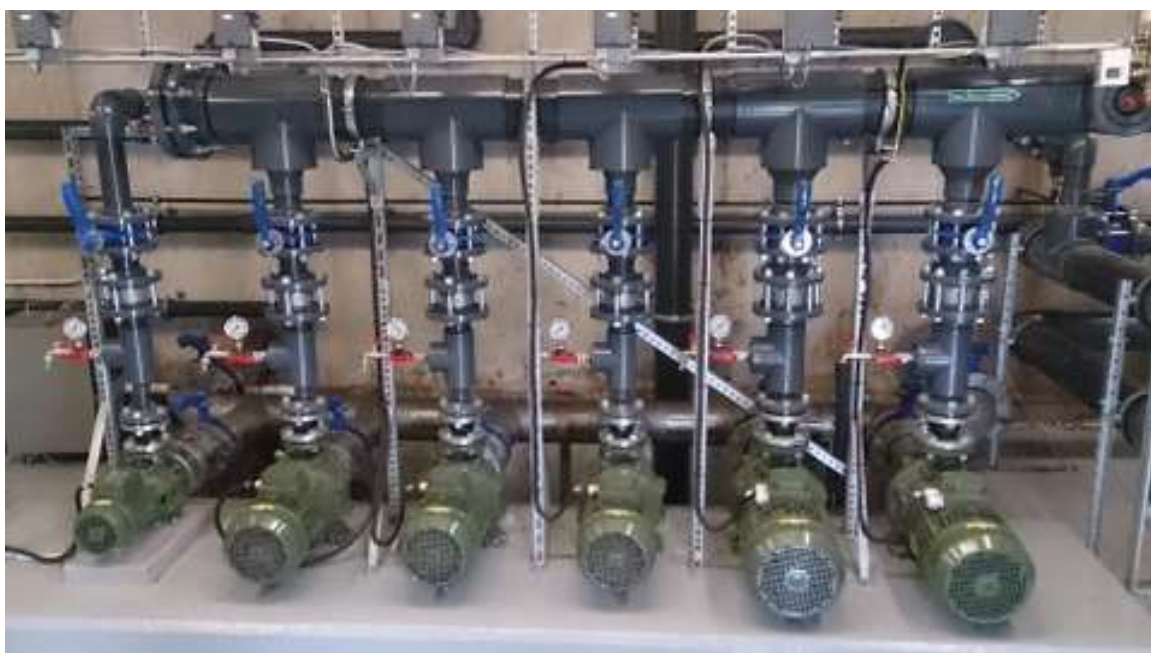
Foto 13. Pärnu-Jaagupi veetöötlusjaama sisevaade
