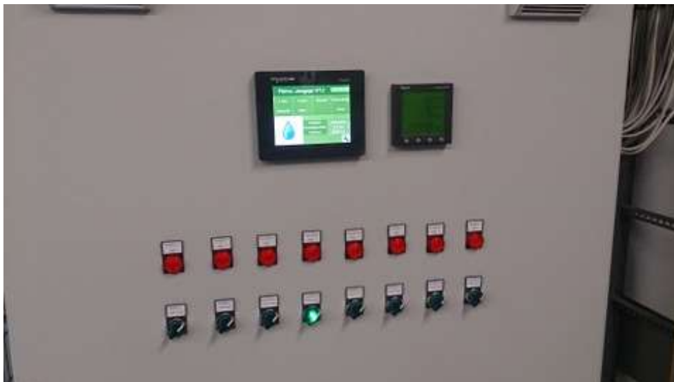
Foto 15. Elektri-automaatikakilp Pärnu-Jaagupi veetöötlusjaamas
