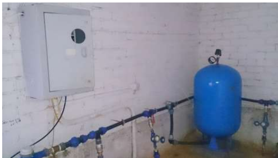
Foto 48. Kergu keskuse puurkaev-pumpla sisevaade
