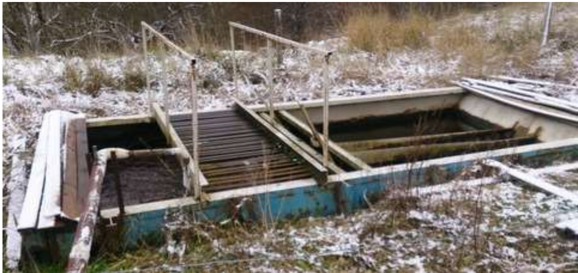
Foto 55. Kaansoo küla reoveepuhasti aeratsioonimahuti
