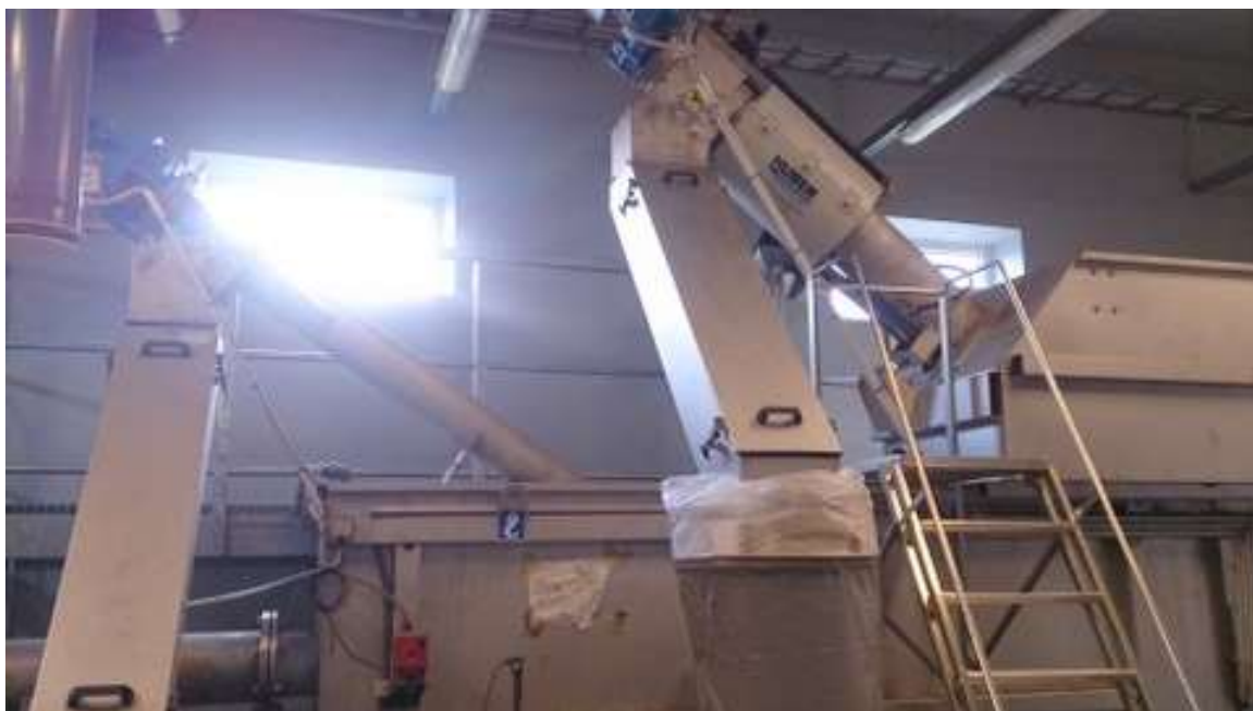
Foto 18. Pärnu-Jaagupi reoveepuhastihoone sisevaade II
