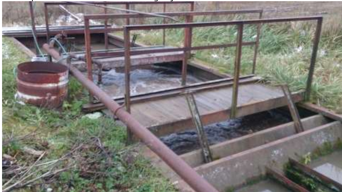
Foto 39. Pärnjõe küla reoveepuhasti aeratsioonimahuti
