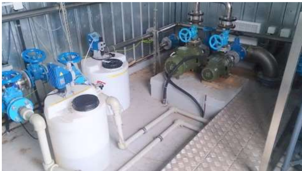
Foto 25. Vahenurme veetöotlusjaama desinfitseerimiseseadmed
